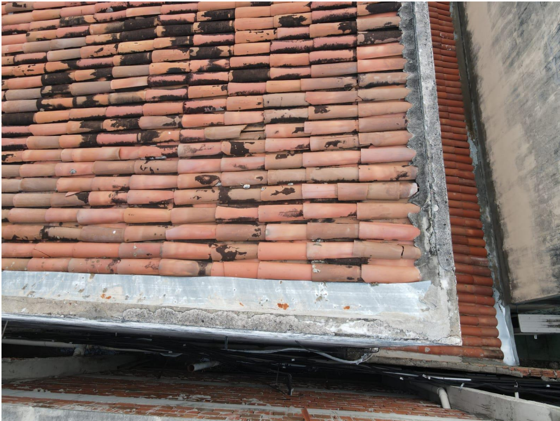
Figura 11-Condição do telhado
