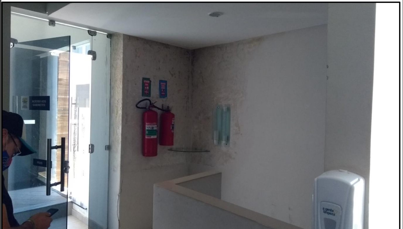
Foto 8 - Mancha devido a infiltração no térreo
