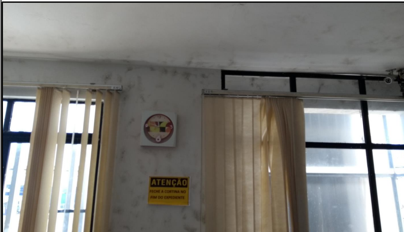
Foto 9 - Mancha de infiltração da recepção do pavimento superior
