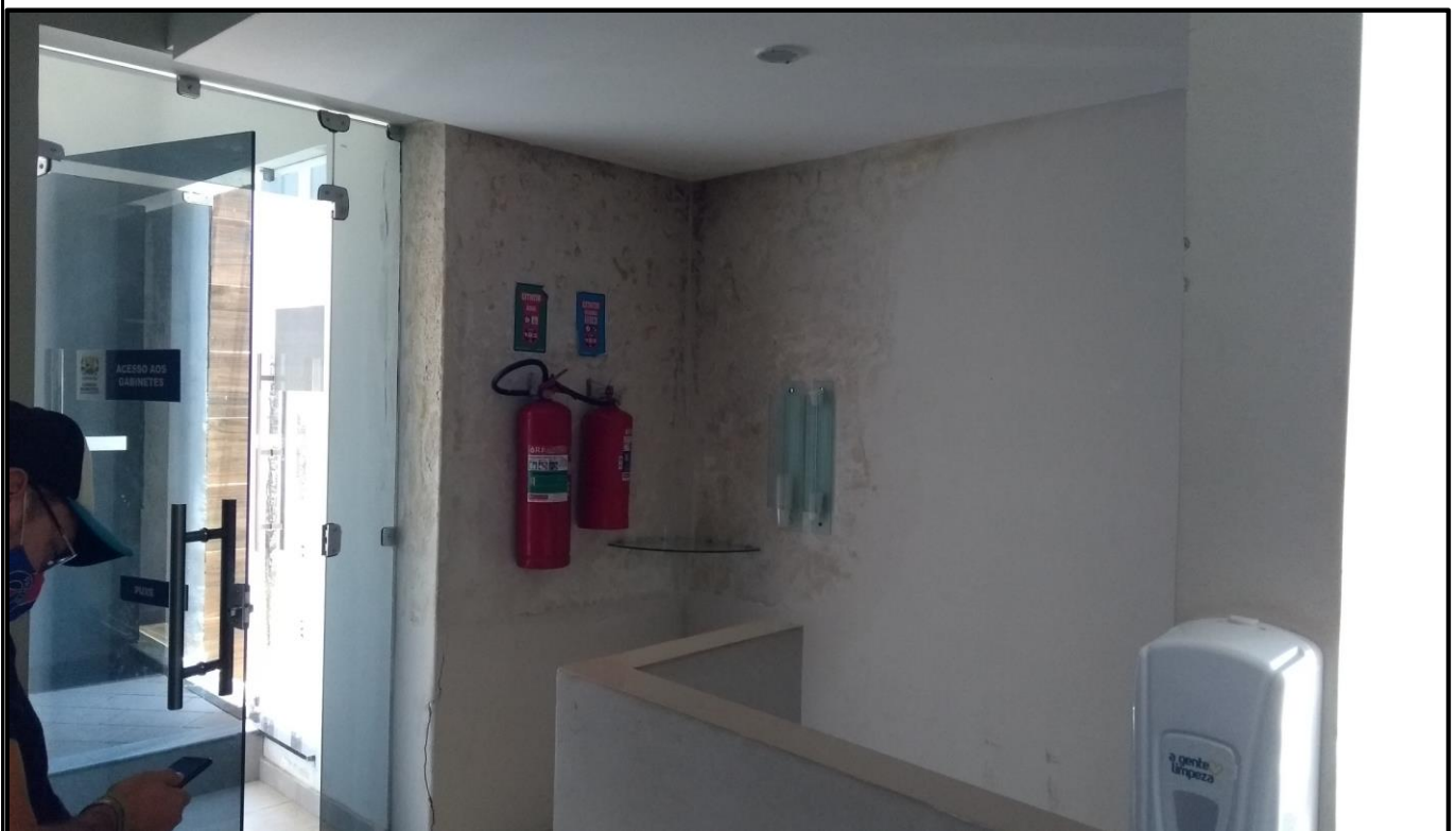
Foto 8 - Mancha devido a infiltração no térreo
