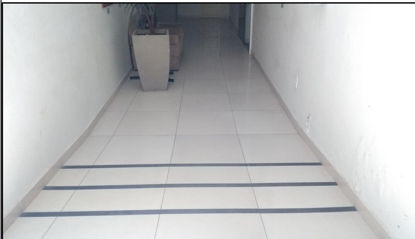
Foto 10 - Rampa no corredor do térreo para corrigir a inclinação
